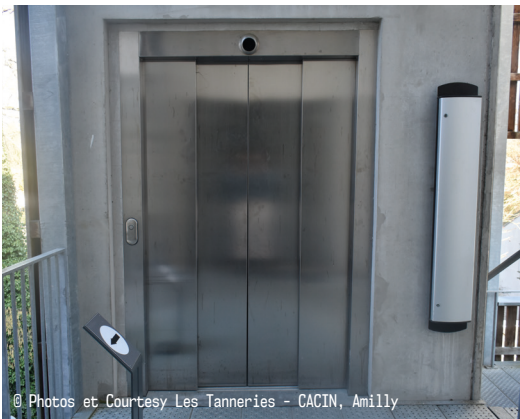
Ascenseur à l'étage
