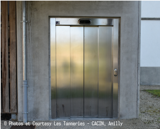
Ascenseur au rez-de-chaussée
